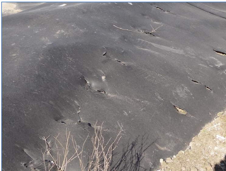
Figuur 11: schade door rupsvoertuig
