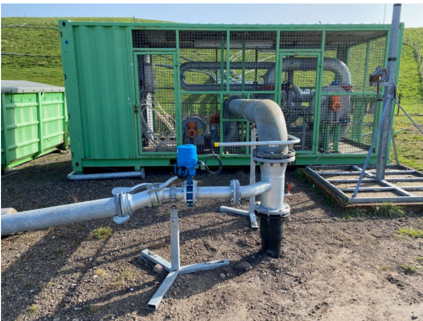
Figuur 6: Aansluiting op nieuwe fakkell via T-stuk met bypass met automatische klep naar biofilter (maart 2021)
