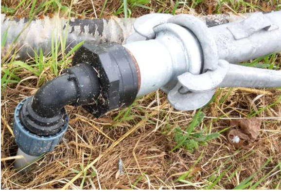
Figuur 2: Gasbron en aansluitleiding
