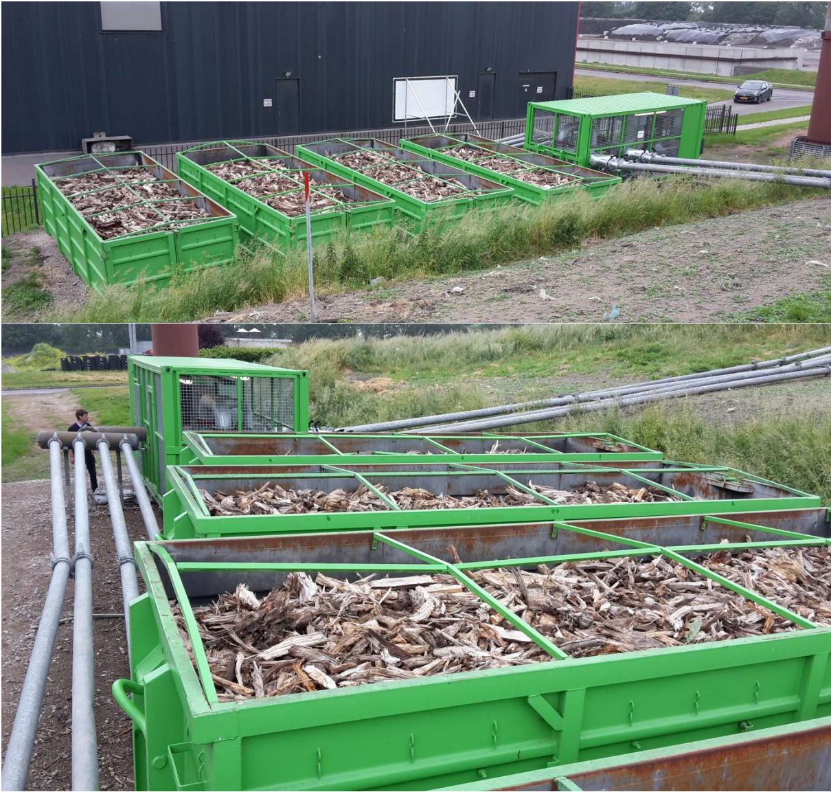
Figuur 4: Beluchttingsinstallatie en biofilters
